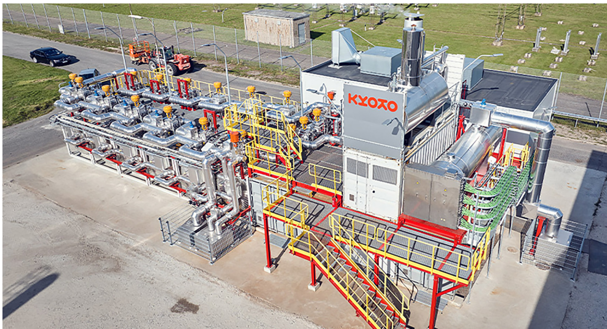
Fig. 3: El Heatcube de Norbis Park ha sustituido al carbón para la calefacción urbana en Aalborg (Dinamarca). Está cargado con 5 MW y presenta una capacidad de almacenamiento de 18 MWh. Este Heatcube reduce las emisiones en hasta 2000 toneladas de CO 2 al año.
